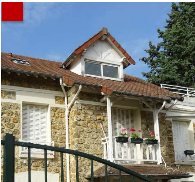
A éviter : lucarne qui ne respecte pas l'ordonnement et les proportions des baies existantes
