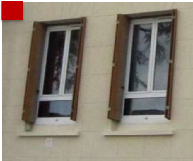
A éviter : les menuiseries de fenêtre en PVC
