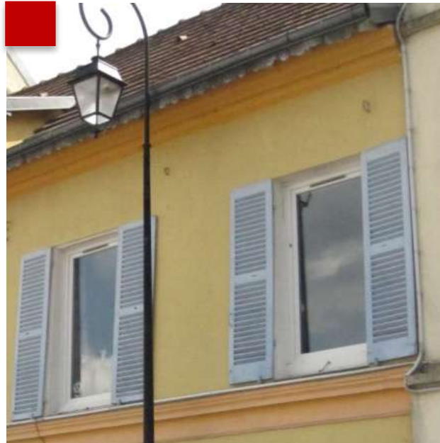
A éviter : les menuiseries de fenêtre en PVC
